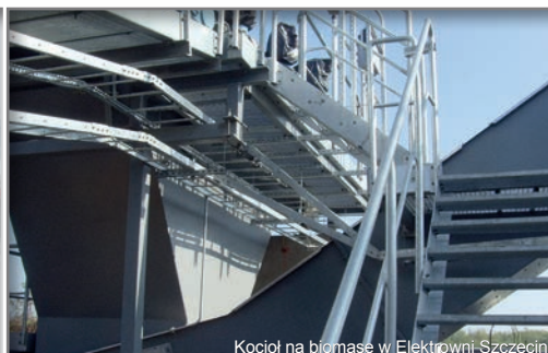
Kociół na biomasę w Elektrowni Szczecin
