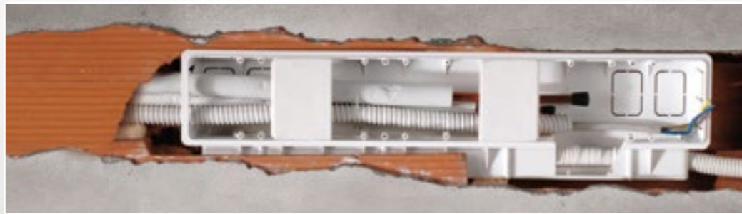
La predisposizione di un impianto condizionamento. Predisposition of air conditioning plant.
