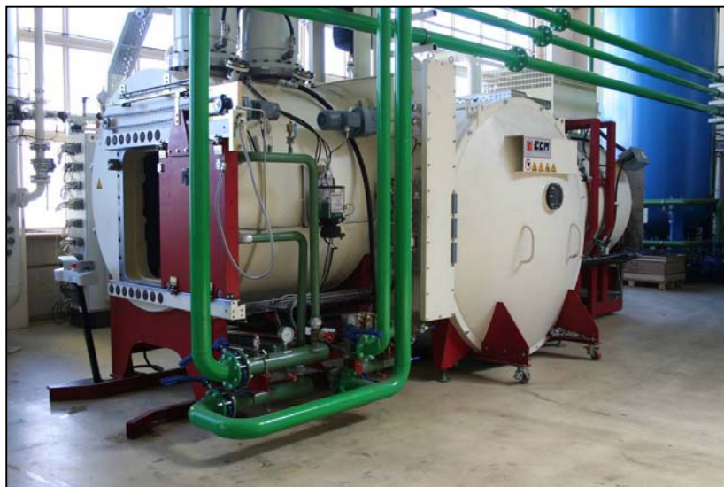
Rys. 2 Piec do nawęglania próżniowego w Bodycote Polska z możliwością rozbudowy o kolejne komory
